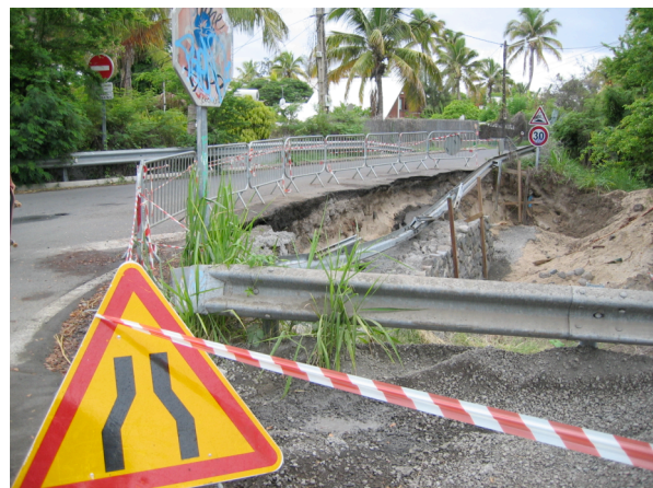
Photo 3. Exemple des dégâts occasionnés à Grand Fond lors de la tempête tropicale précédente du 18 au 23 février 2006
